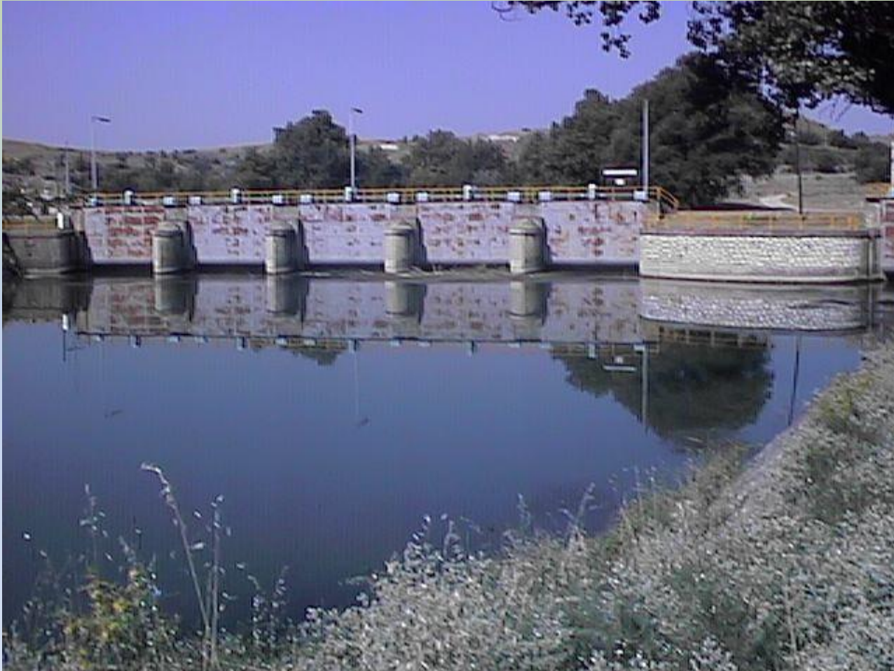
Ρυθμιστές στο φράγμα της Συμβολής
