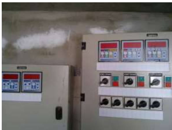
Εικόνα 3.7 Κεντρικοί πίνακες ελέγχου
